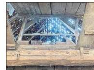
Das Dach des Denkmals ist teilweise zerstört.
