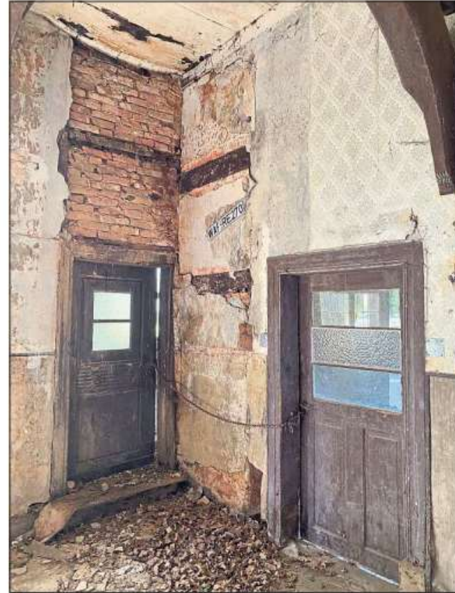
Verwunschener Ort: Das marode Fachwerkhaus in Vellern wird nicht mehr genutzt. Der Plan, es nach Drensteinfurt zu versetzen, konnte bislang nicht umgesetzt werden.
