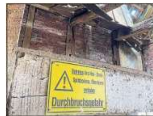
Achtung, Durchbruchgefahr: ein Schild unter dem Dachboden.
